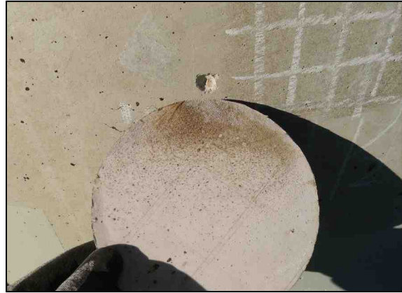
b. 탄산화시험부 변색 확인
